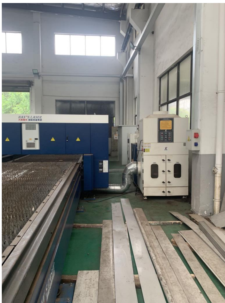
图 4.2-1 烟尘收集处理装置
